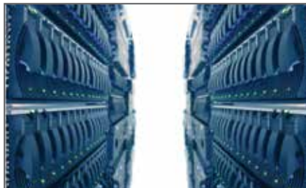
データセンター
