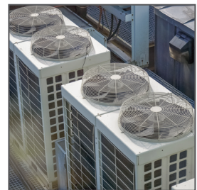
暖通空调设备
